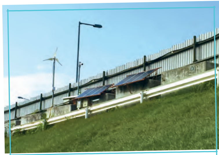
可再生能源（太陽能及風力）用於照明系統
