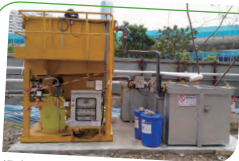
污水處理設施
